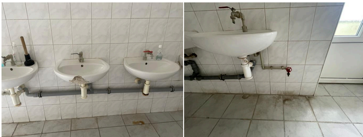
Stav zariadení na osobnú hygienu v RC Tornaľa pri prvej previerke Generálnej prokuratúry Slovenskej republiky
